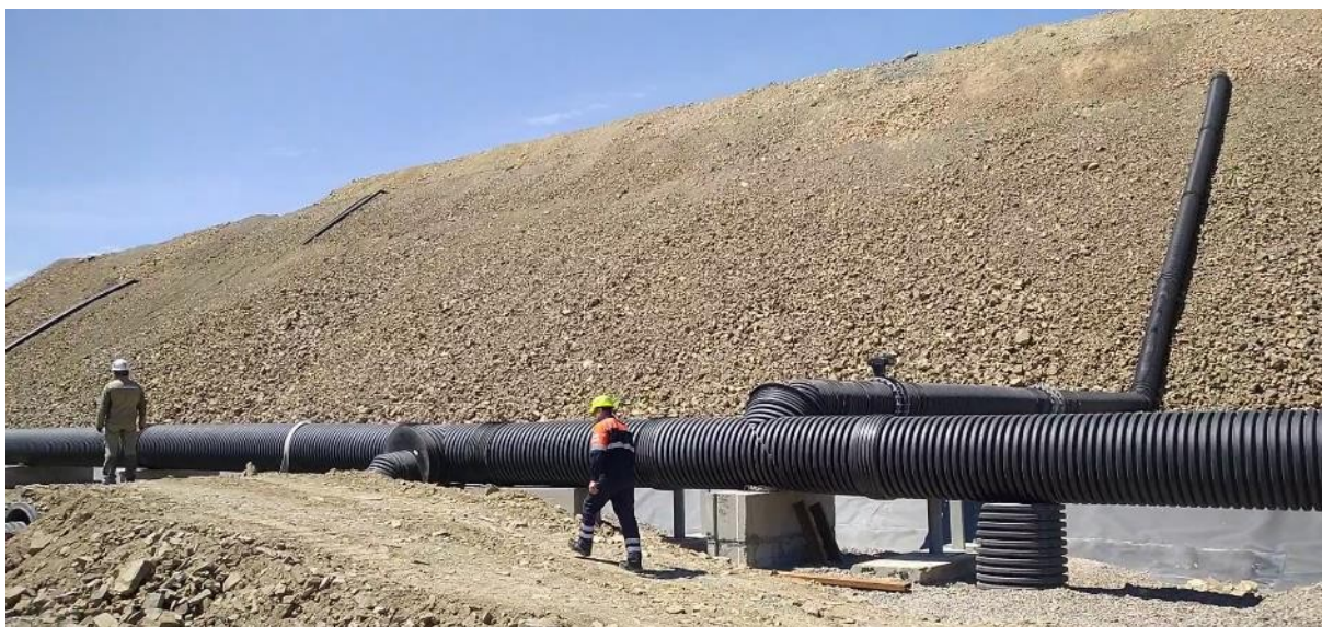
Рис.9 ПКВ-2. Коллектор подачи воздуха
